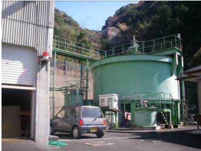
A鉦山坑廃水処理場
