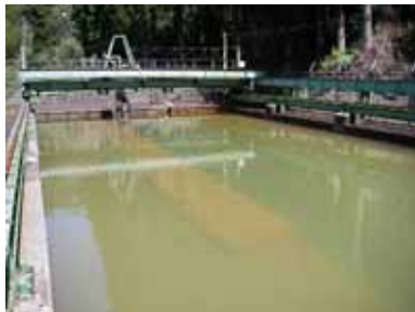
沈殿池と揚泥ポンプ
