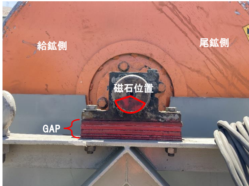
写真 1 GAP および磁石位置
